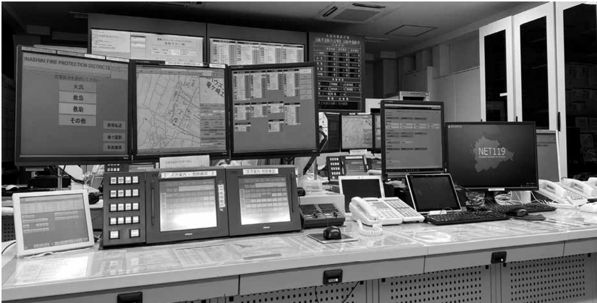
●高機能消防指令センター
