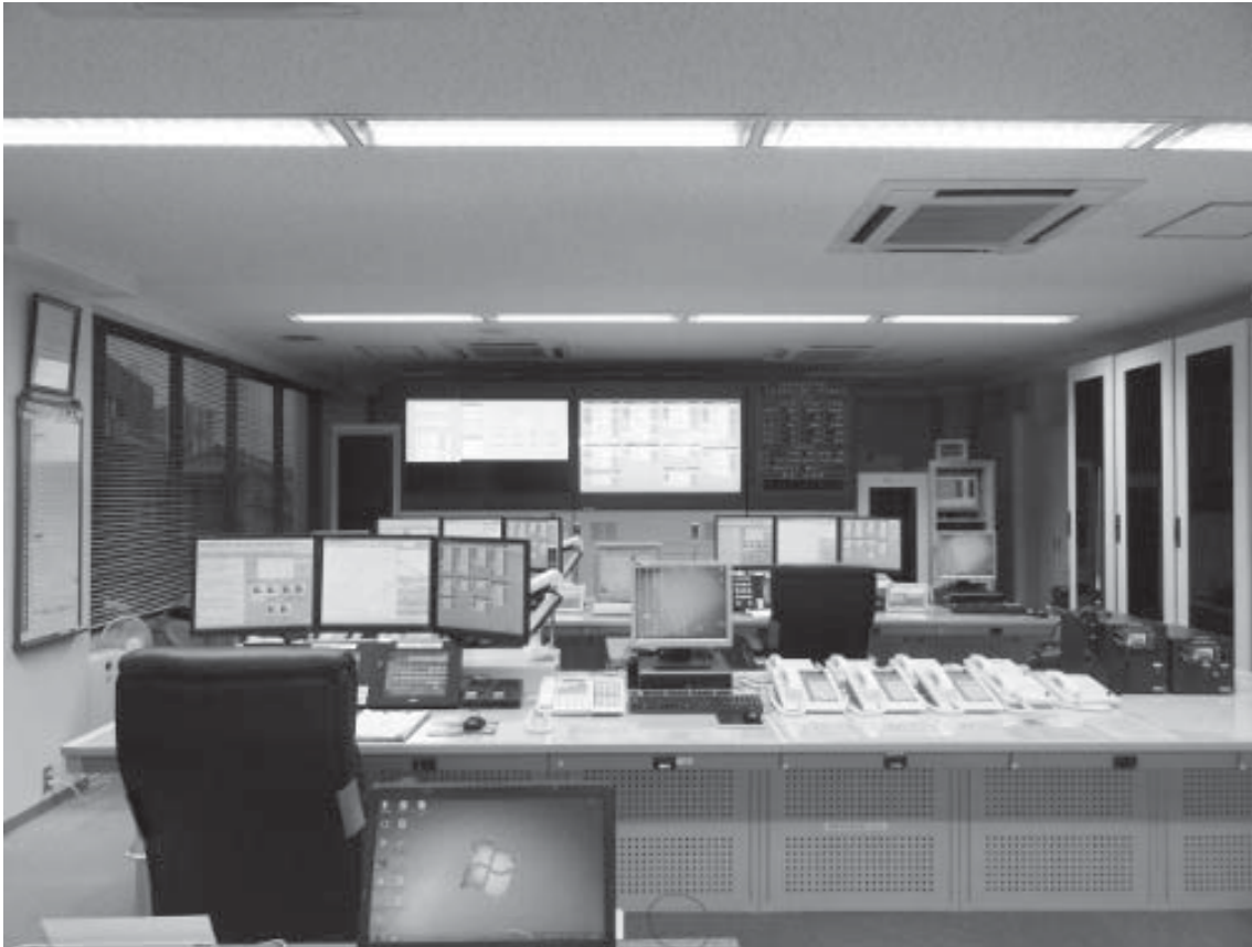
●高機能消防指令センター
